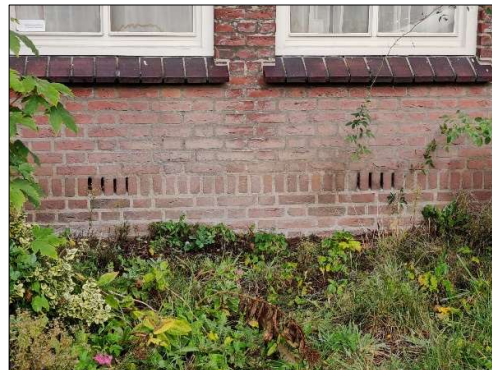
Figuur 8: Stootvoegen vlak boven maaiveld.
