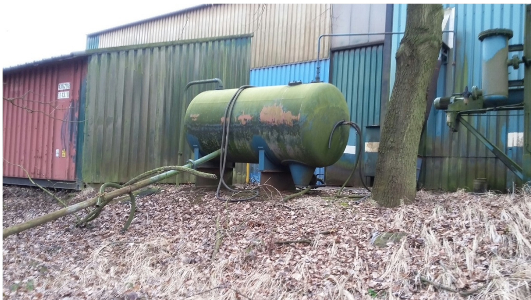
Foto: zuidelijke perceelsgrens met talud, tank condenswater, kijkrichting noord
