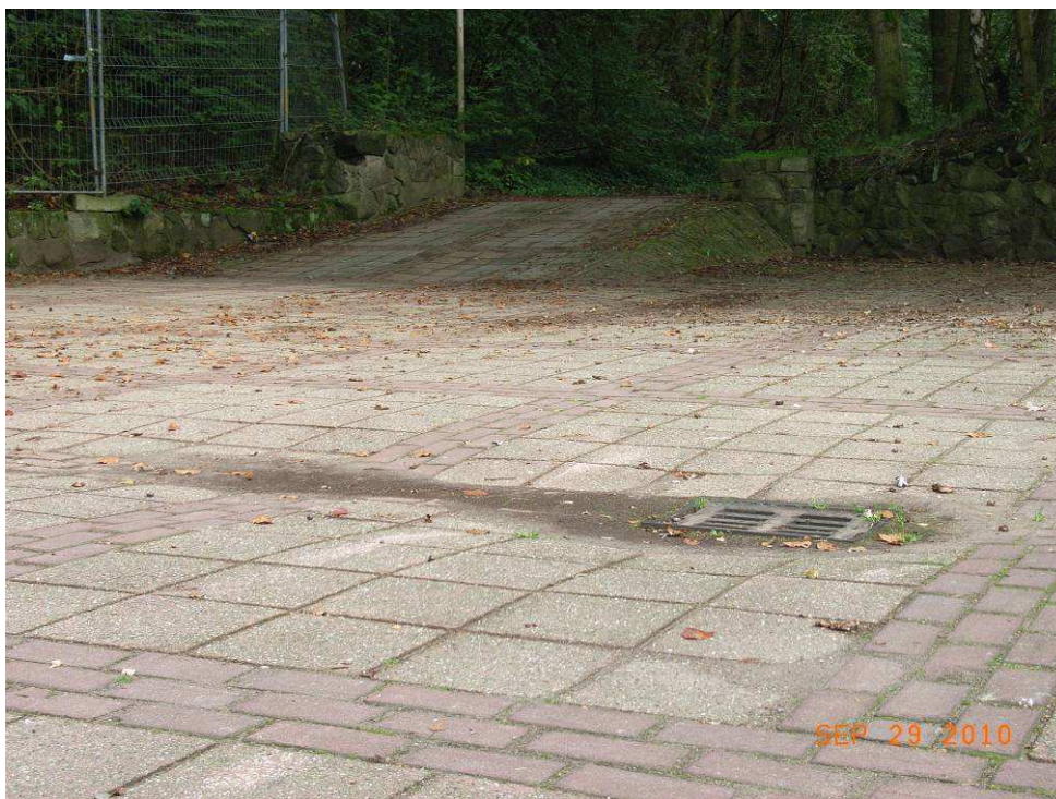
Verzakking en slechte afwatering entreeplein
