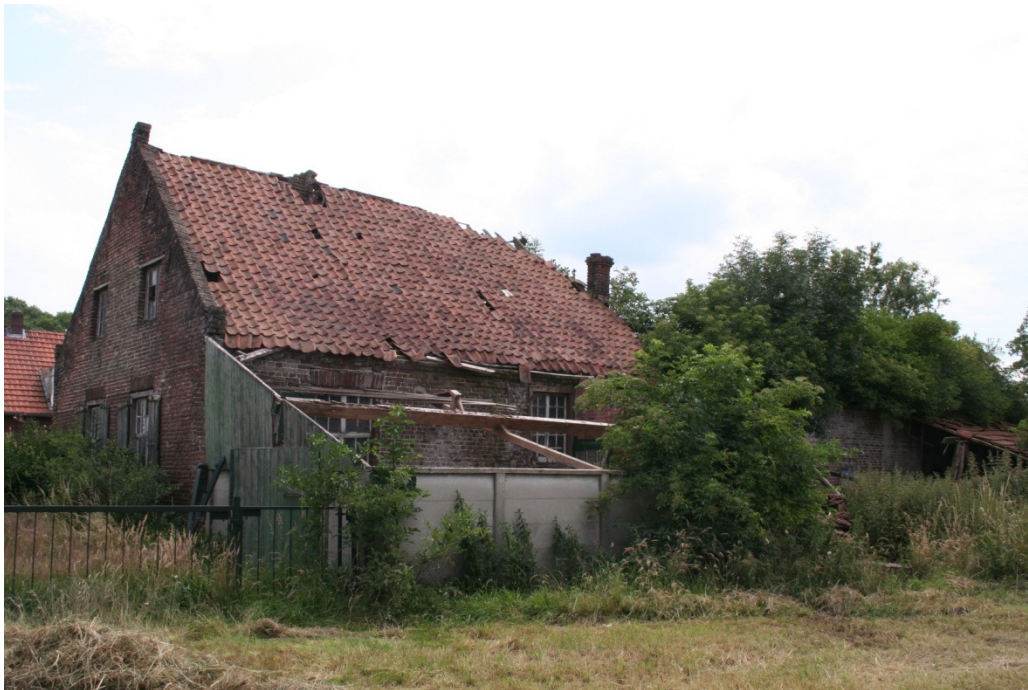
Foto 1. Te restaureren vervallen bebouwing op de onderzoekslocatie
