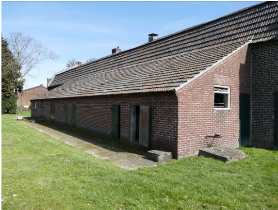
Figuur 17 De aanbouw aan de achtergevel loopt niet door tot aan de eindgevel
